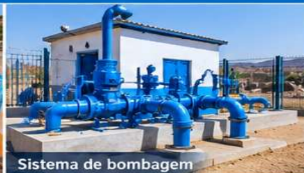
Sistema de bombagem
