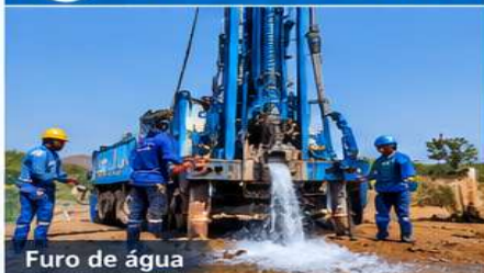
Furo de água
